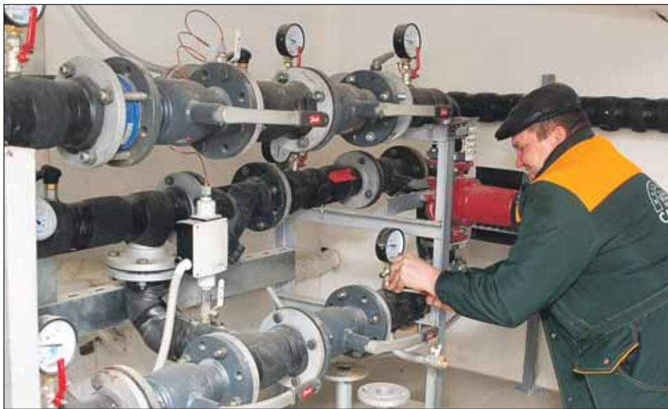
Автоматизированный узел управления системой отопления установлен в двух домах на Изумрудной
