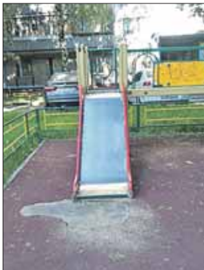
На детской горке на Студёном, 15, стёрлось покрытие
