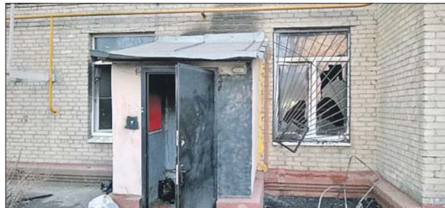
Пожар произошёл здесь
