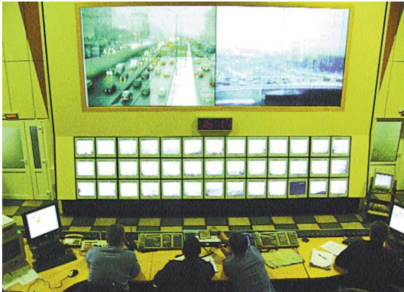
В зале оперативного управления
