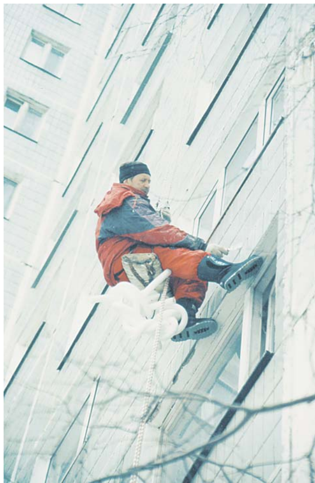
Вдоль межпанельного шва
