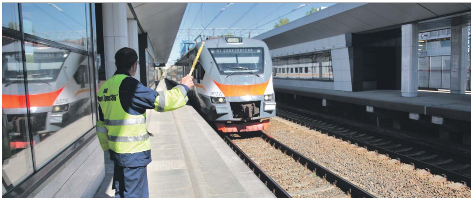
Новая платформа почти готова, остались последние штрихи. А пока электрички проезжают мимо неё чуть дальше — до временной остановочной площадки
