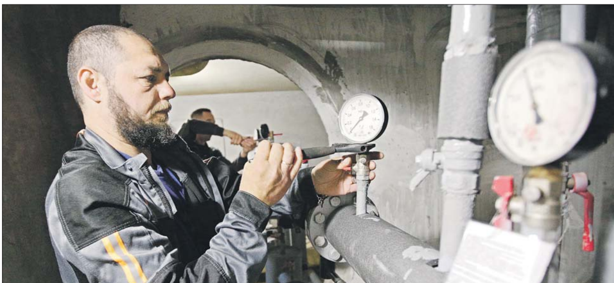
В доме на Ясном проезде ставят новые манометры на тепловом узле
