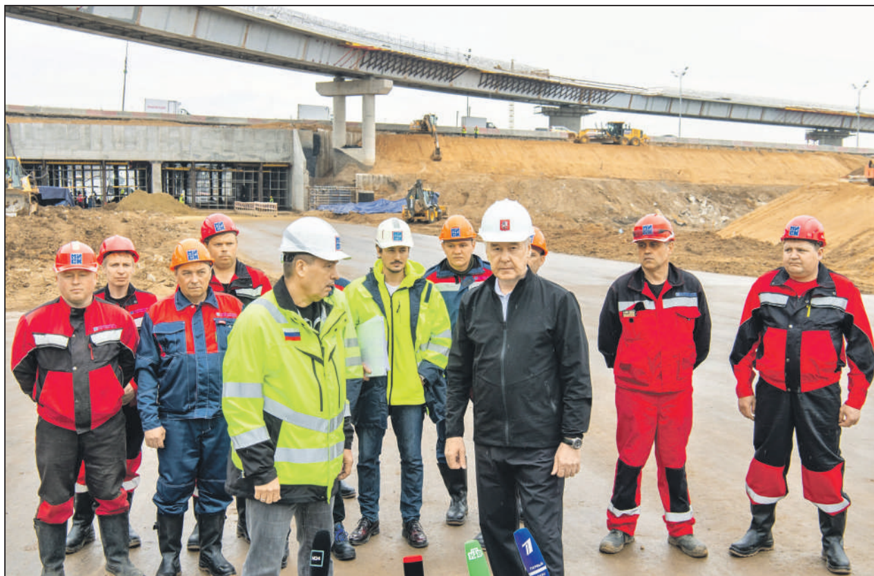
Мэр осматривает строящийся участок трассы, связывающей МСД с дорогой Солнцево — Бутово — Варшавское шоссе
