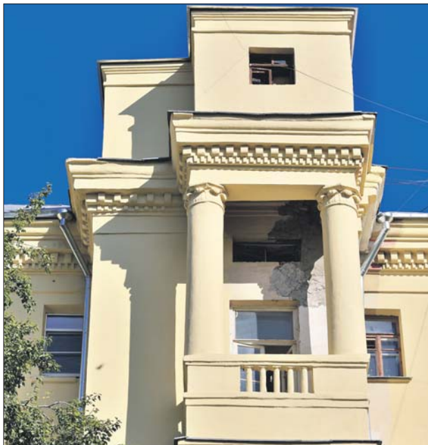
В 2022 году от вибраций лифта по фасаду пошла трещина
